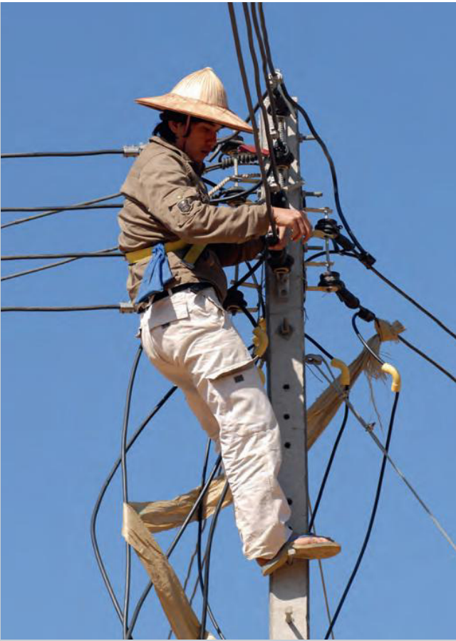
Aufbauarbeit: Um den Erneuerbaren-Strom aufnehmen zu können, müssen die Netze in Südostasien vielerorts stark erweitert werden.
